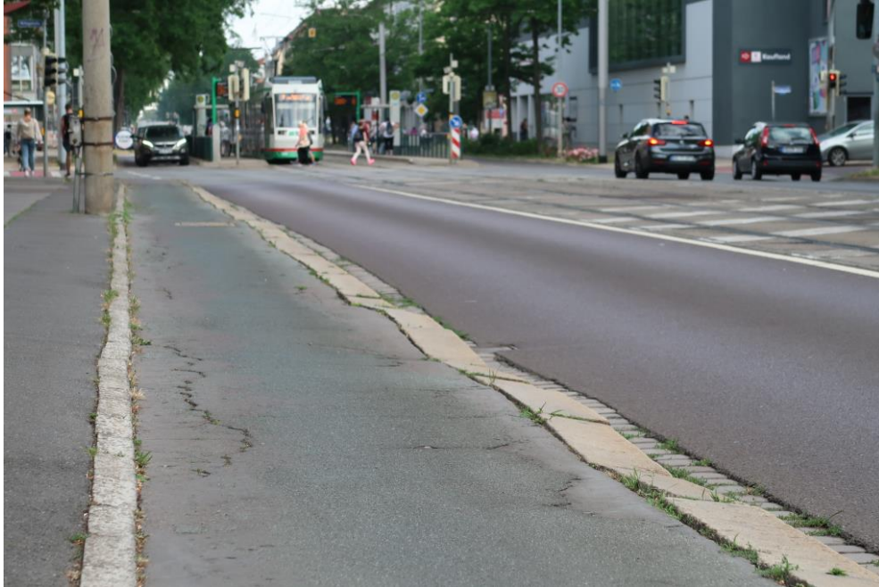
Foto: Schäden im westlichen Seitenraum der Lübecker Straße © VCDB
