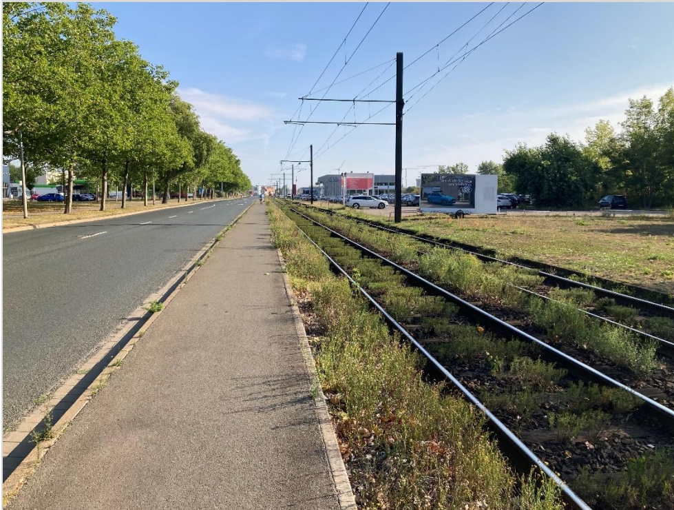
Foto: August-Bebel-Damm, Radweg an der Ostseite mit großen Sicherheitsdefiziten © IB Buschmann
